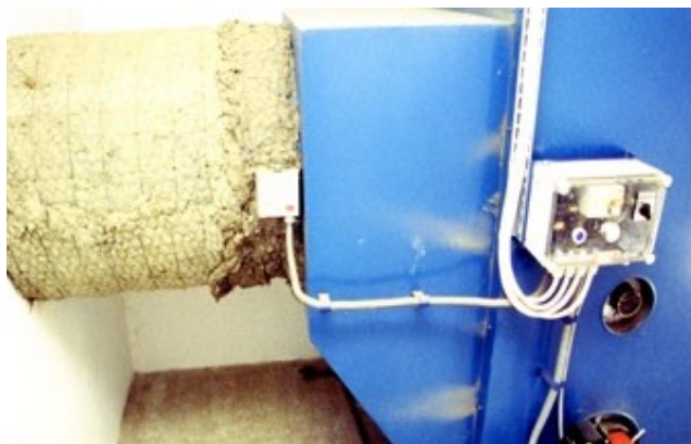
Varmluftskanalen i pannrummet ska alltid vara isolerad.
